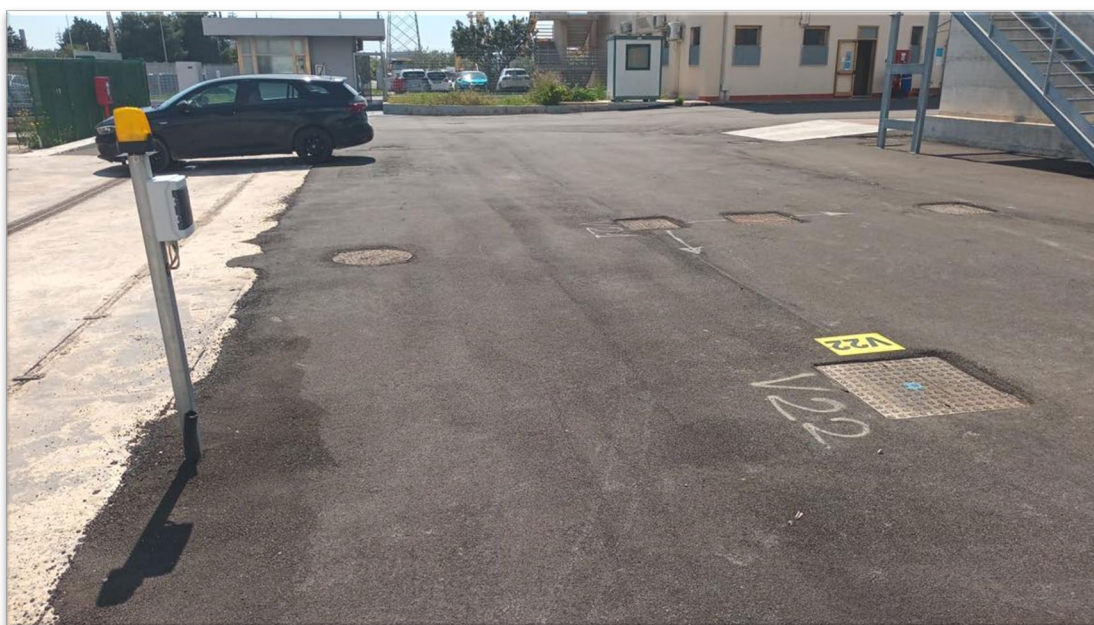
Immagine 1 – Vasca interrata V22 dedicata alla raccolta delle acque meteoriche di I° pioggia
